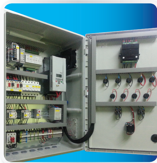
Przykład montażu aparatury sterowniczej i osprzętu
